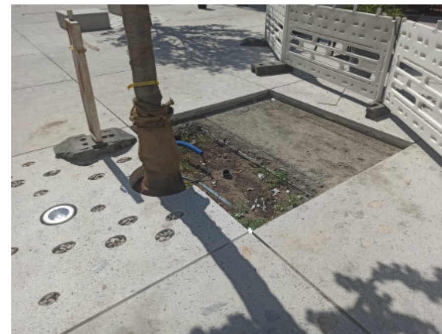
Ryc. 55. System nawadniania i napowietrzania bryły korzeniowej na Placu Pięciu Rogów w Warszawie
