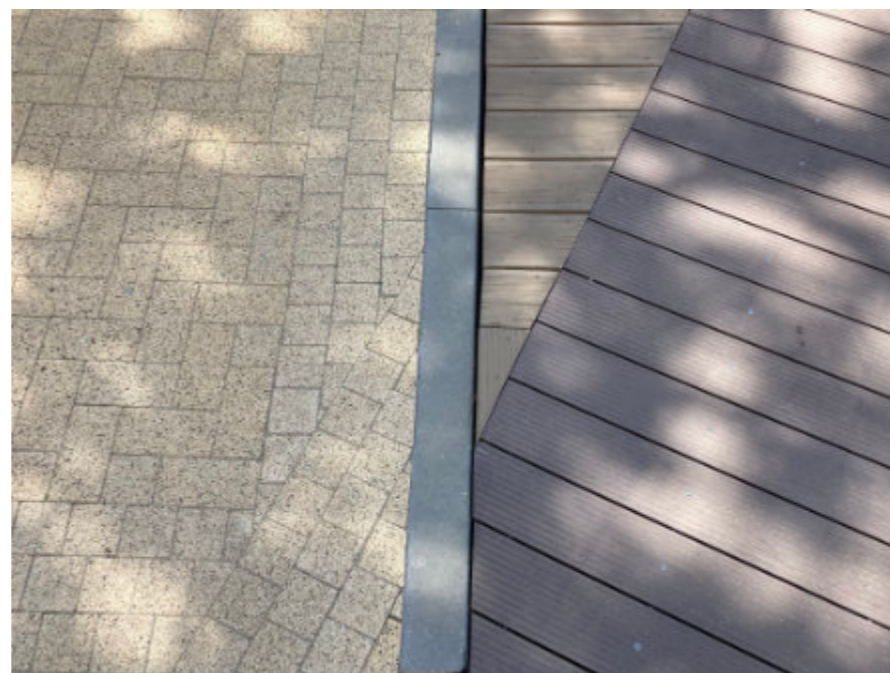
Ryc. 50. Zbyt duża liczba materiałów nawierzchni (bulwar w Malborku)
