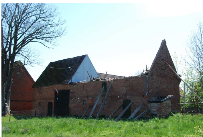
Fot. 15. Swołowo, ruiny budynku bramnego w zagrodzie nr 23
