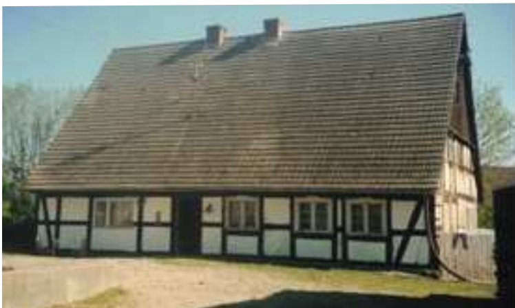
Fot. 35., fot. 36. Starkowo, dom mieszkalny nr 40 W obiekcie przykład nieprawidłowo wymienionej stolarki.
