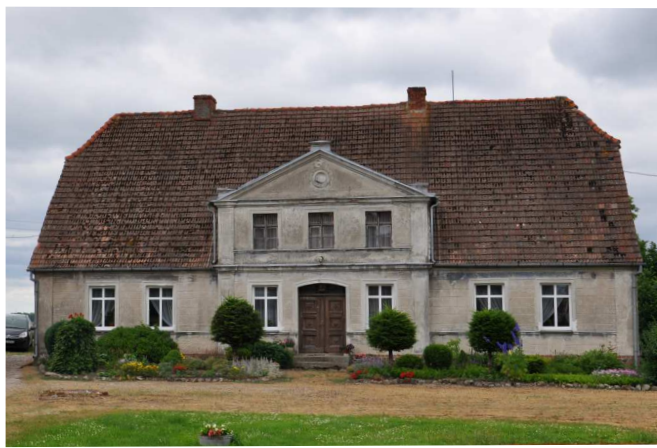
Fot. 76. Bruskowo Małe, dom mieszkalny nr 13, fotografia archiwalna, obecnie blachodachówka - nieprawidłowa wymiana pokrycia dachowego
